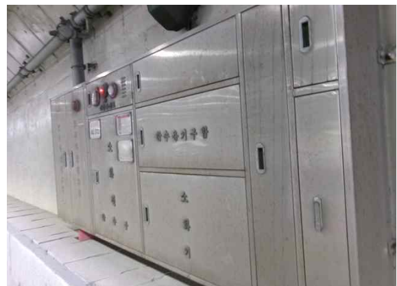
성산방향 소화전 전경
